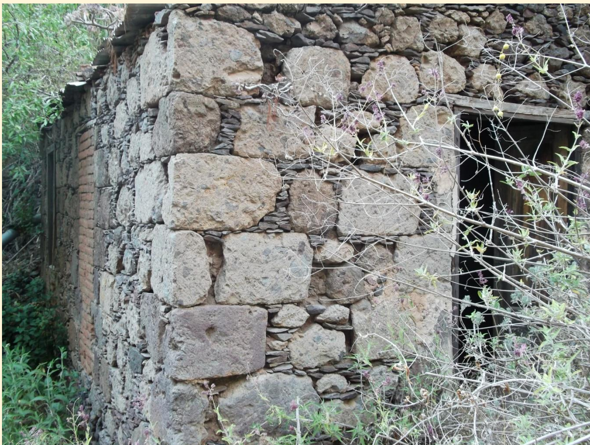
Detalle de un antiguo molino de agua en la zona de El Sao. Para la fabricación de los muros de mampostería se usaron materiales locales, correspondiéndose a brecha y tobas del ciclo Roque Nublo, junto con lajas y cantos fonolíticos y basálticos del Ciclo I. Foto: Francisco Betancort.
